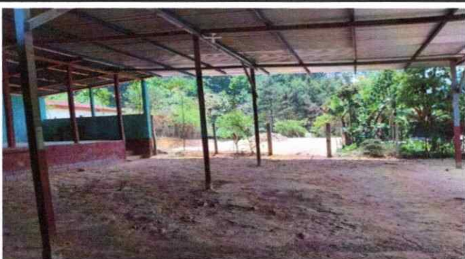
Foto 3: Se observa el patio de la escuela en donde se llena de polvo en tiempo de verano y se llena de lodo en tiempo de lluvia y se requiere reparación de losa de patio.
