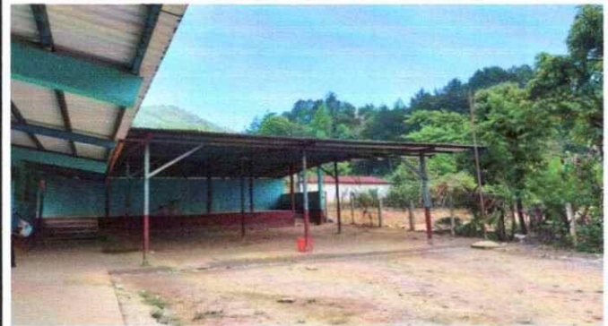
Foto 2: Se observa el entechado muy deteriorado.
