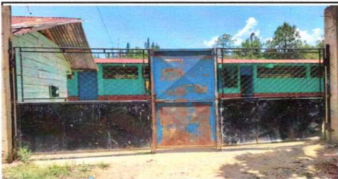
Foto 5: Se observa el porton muy deteriorado.
