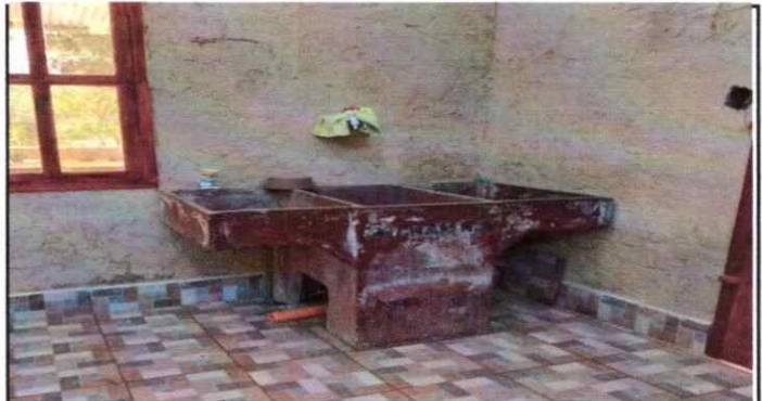
Foto 4: Se observa la pila muy deteriorada la cual necesita ser reemplazada.
