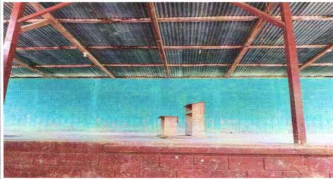
Foto1: Se observa el deterioro de vigas y láminas.
